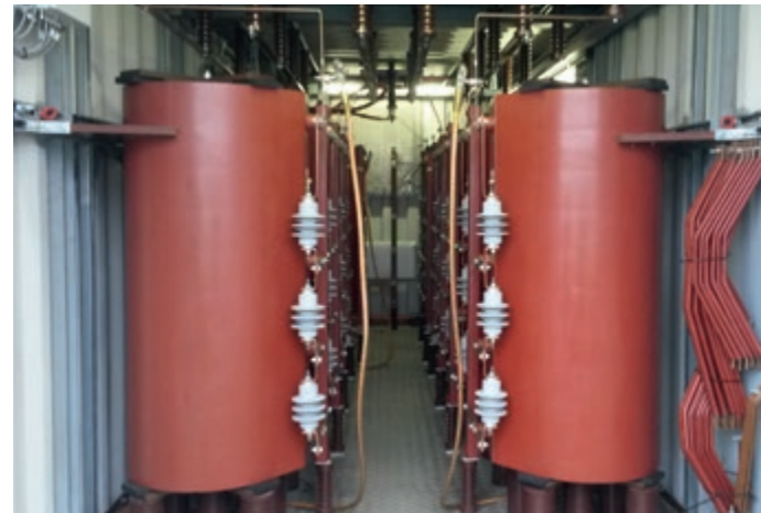
Blick in einen Messcontainer für eine Zertifizierungskampagne im Feld
